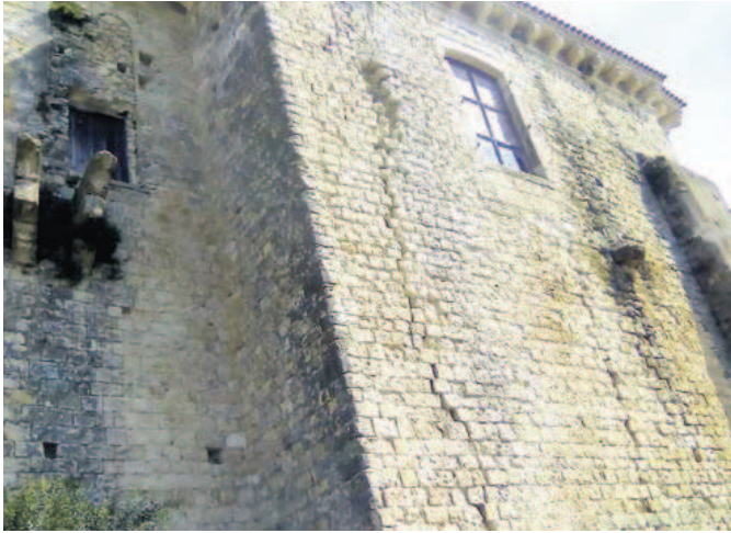
La tour carrée a besoin de travaux de consolidation./Photo DDM GC
